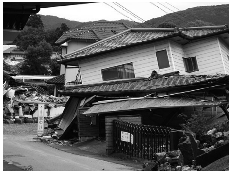
【熊本地震被害状況】
